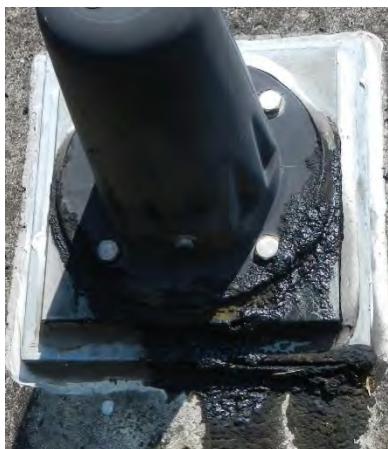
樹脂キャップの熱劣化変形に伴うグリース漏出
