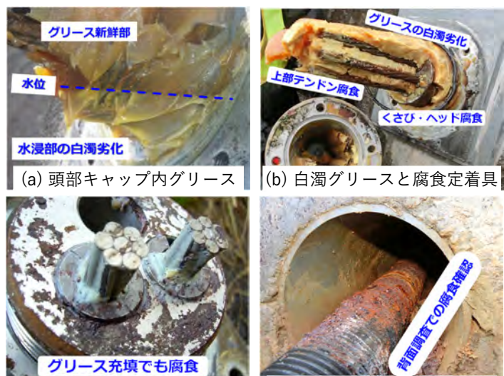
図-4.12.2 アンカー頭部の腐食実態
