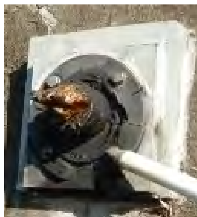
上部引張破壊と下部圧縮破壊の融雪沈降力に伴う樹脂キャップの破損
